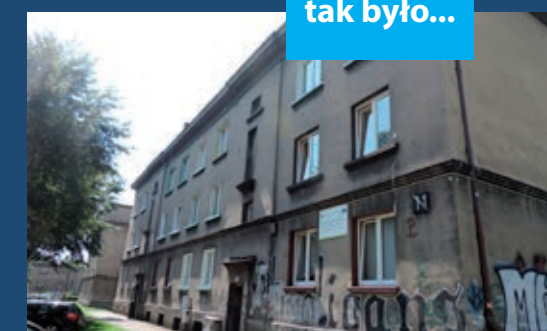
Stare, nieestetyczne elewacje.
